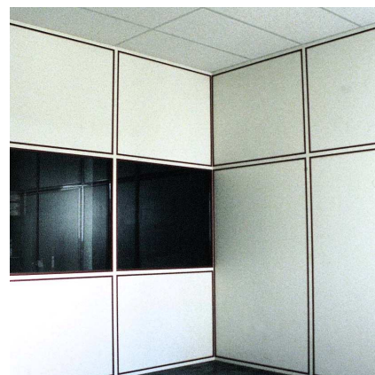
Cloison bureau d'atelier avec plafond autoportant isolé.
